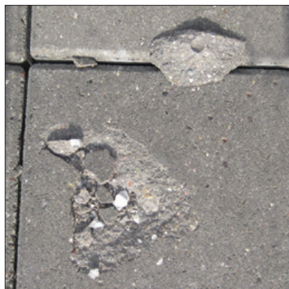
En "kalkspringer", dvs. en vandmættet kalksten har udvidet sig i frostvejr, og presset en flage af betonen.
